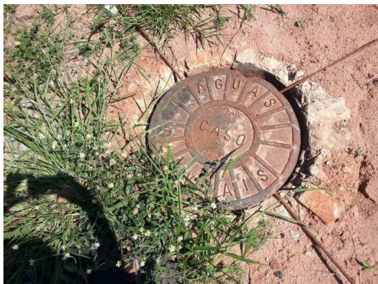
Figura 49 Poço de visita do sistema de drenagem aberto.
