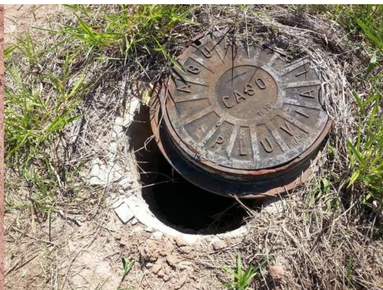
Figura 50 Poço de visita do sistema de drenagem aberto.
