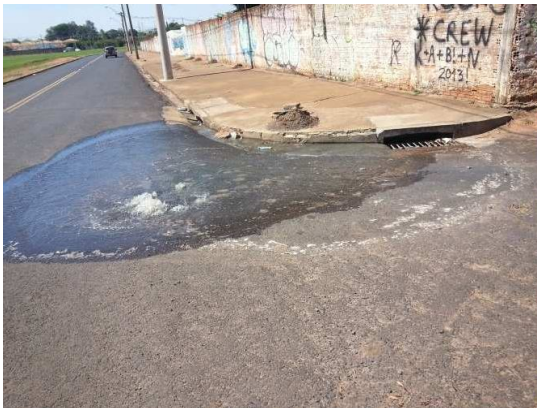
Figura 47 Vazamento de esgoto para o sistema de drenagem.
