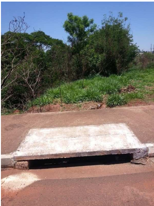
Figura 43 Vista frontal da boca de lobo com lançamento no rio Preto.
