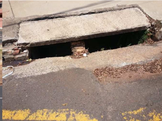
Figura 46 Boca de lobo com necessidade de reparo – Av. Murchid Homsí.
