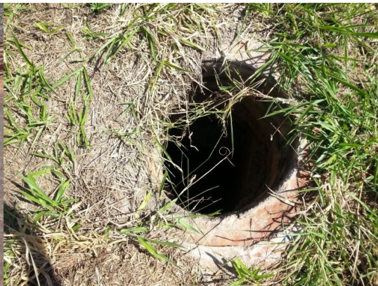
Figura 48 Poço de visita do sistema de drenagem aberto.
