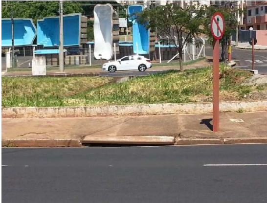
Figura 45 Boca de lobo com necessidade de reparo – lançamento no córrego Borá.
