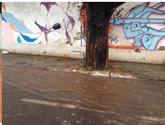
Figura 69 Consequências da falta de estruturas adequadas de microdrenagem.
