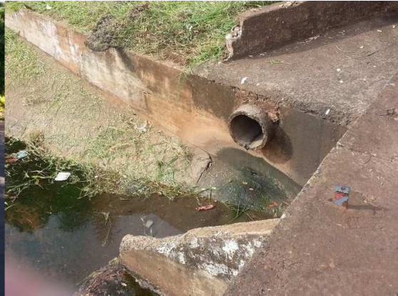
Figura 42 Tubulação de drenagem com lançamento em córrego sem denominação.
