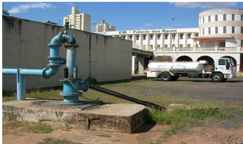
Figura 91 Vista do poço PTG-001
