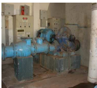
Boa Vistinha - Cj de 250 CV, acionamento e capacitor
