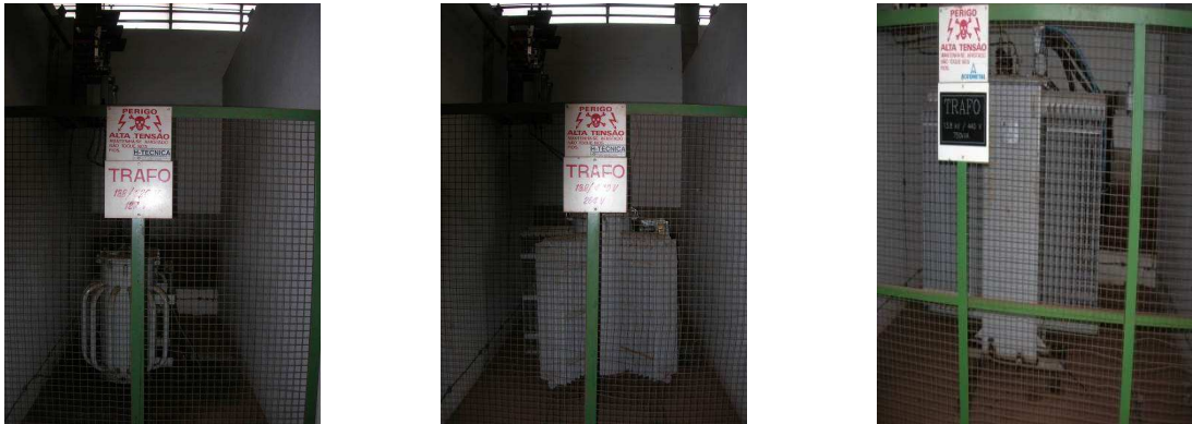
e) PTG-003 e Centro de Reservação e Distribuição Urano
