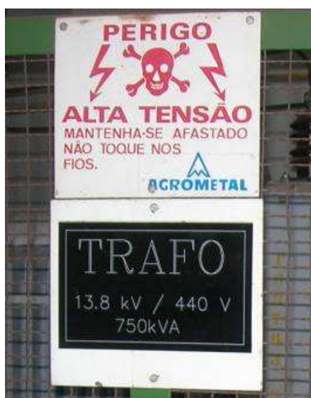
Figura 117 Placa de identificação de transformador de 750 kVA
