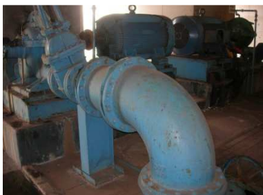
Figura 100 Outros conjuntos do sistema de recalque de água tratada da ETA
