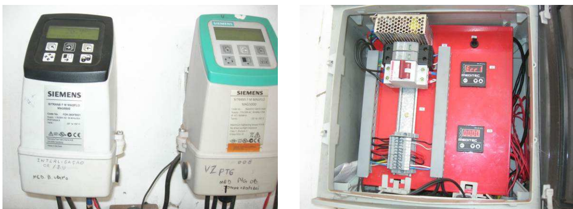
Figura 132 Medidores de vazão e base para a interface de comunicação
