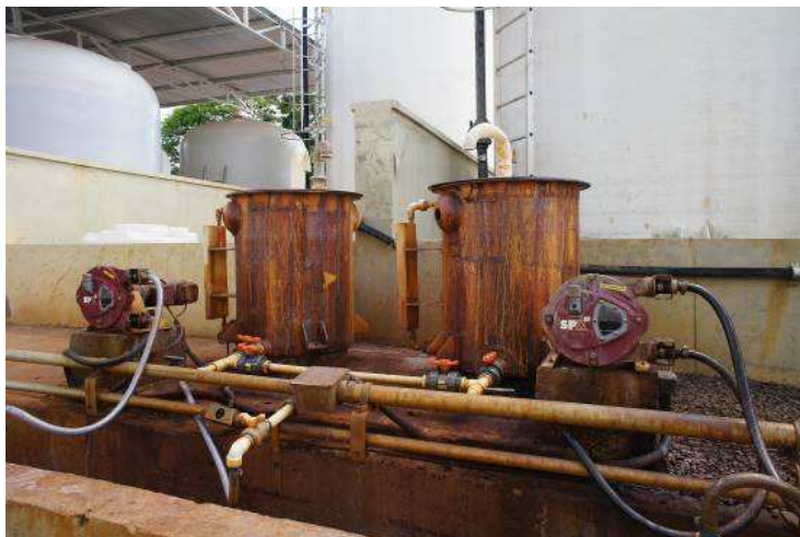
Figura 33 Sistema de dosagem de solução de coagulante composto por bombas peristálticas
