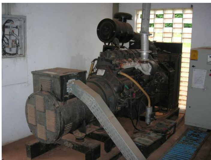
Figura 152 Grupo gerador diesel
