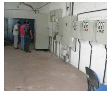
Sala de painéis
