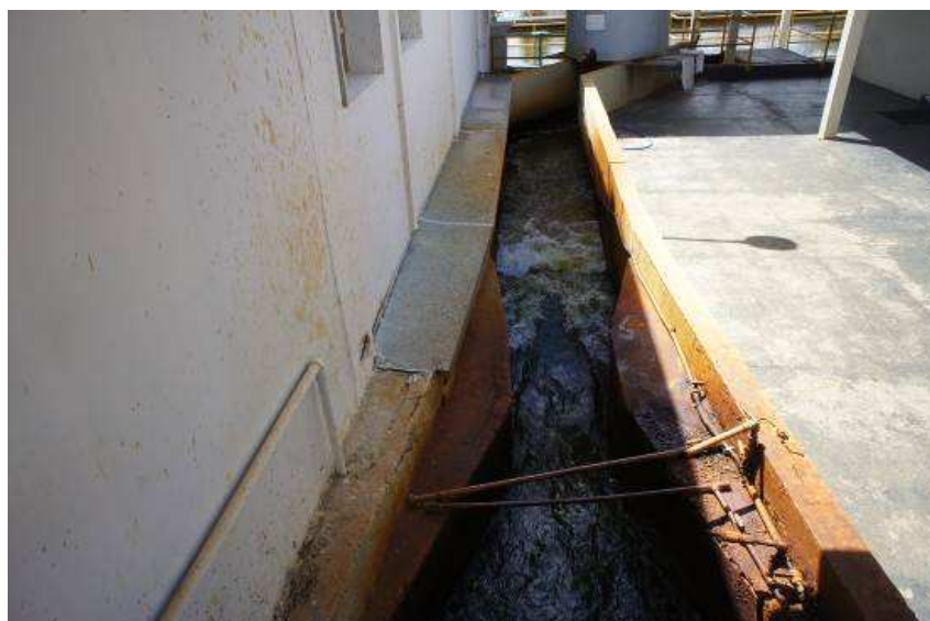
Figura 31 Vista geral da Calha Parshall instalada junto ao canal de água bruta e disposição do coagulante (sulfato férrico)
