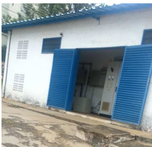
Figura 112 Sala de painéis e trafo auxiliar
