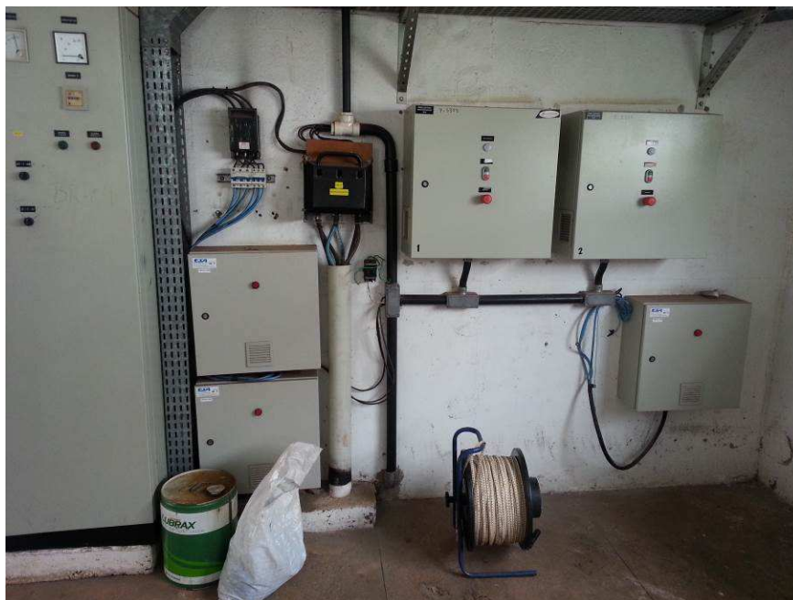
Figura 111 Instalação inadequada de equipamentos de manobra e proteção
