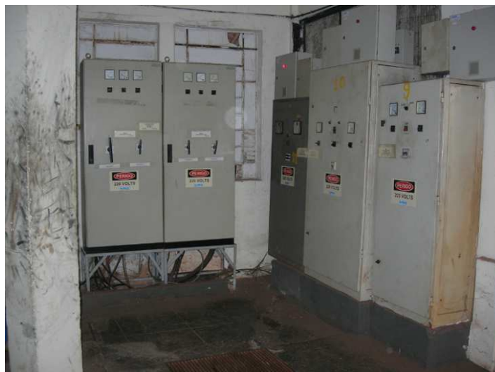
Figura 89 Painéis de acionamento da captação e bancos de capacitores
