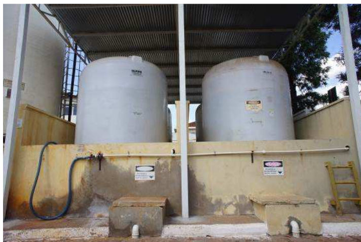
Figura 59 Sistema de estocagem de solução de hipoclorito de sódio
