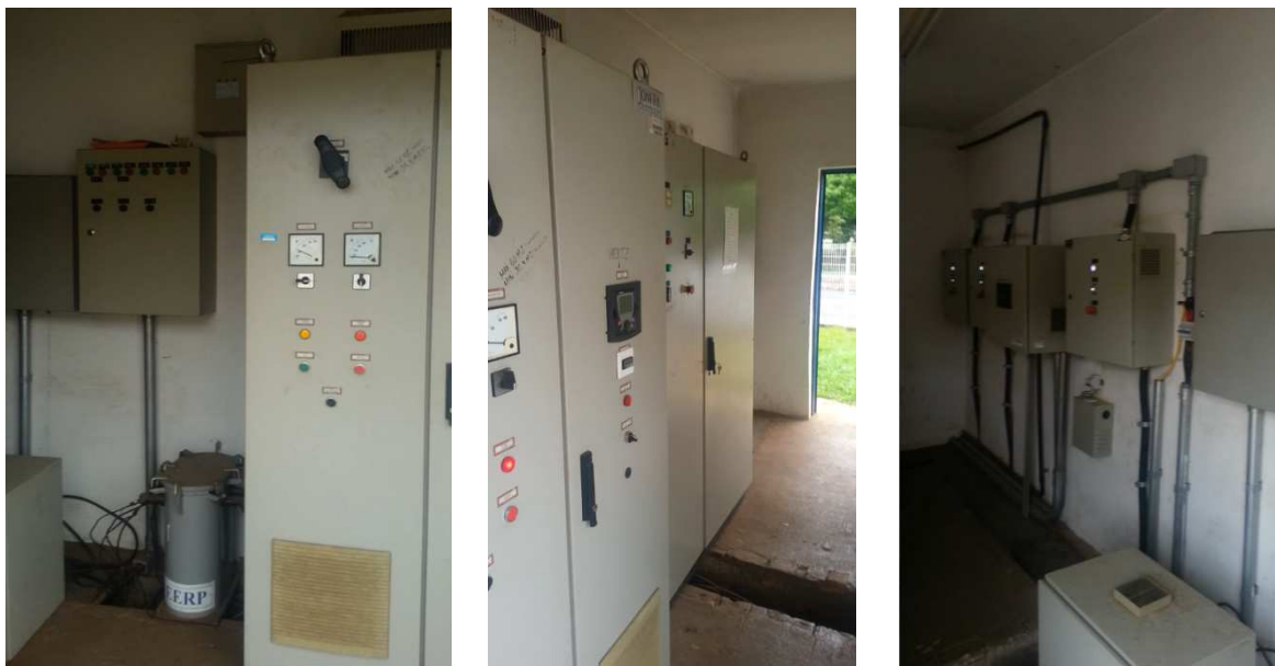
Figura 113 Painéis e trafo auxiliar
