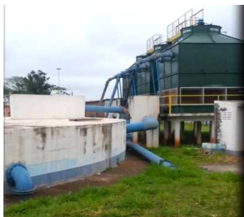
Outro reservatório semiapoiado e torre de resfriamento
