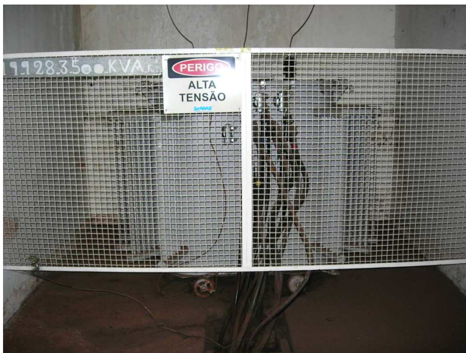
Figura 97 Secundário do trafo para diferentes painéis
