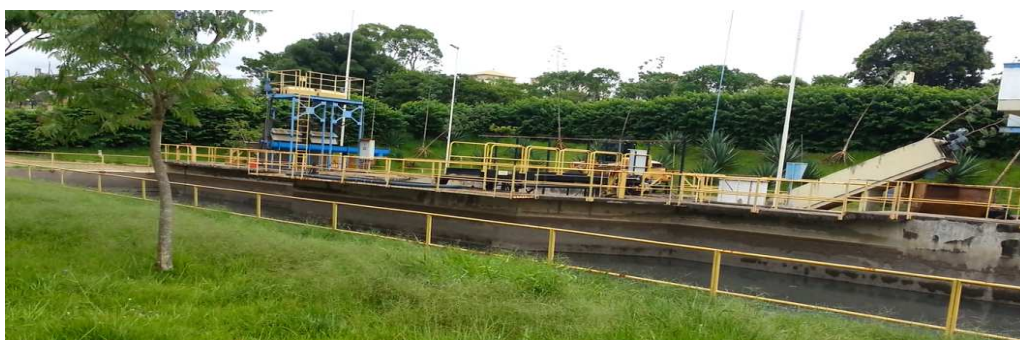
Figura 148 EEE Porto de Areia: vistas das instalações externas
