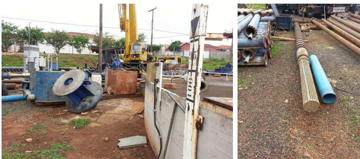
Figura 109 PTG 002 - Penha, em manutenção na ocasião
