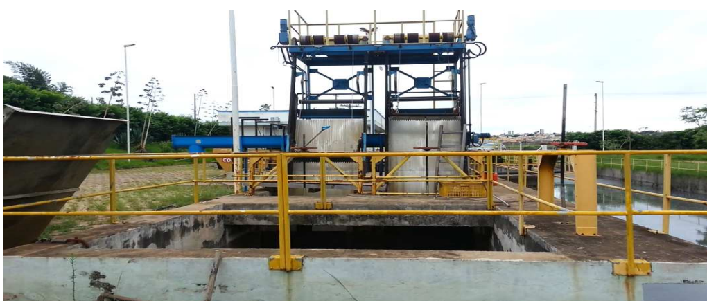
Vista do gradeamento do tratamento preliminar
