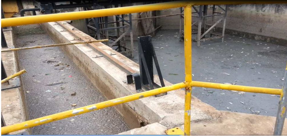
Vista do esgoto bruto que passa pelo bombeamento
