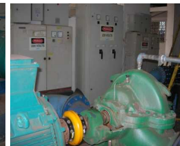
Cj 125 CV, quadro geral e acionamentos
