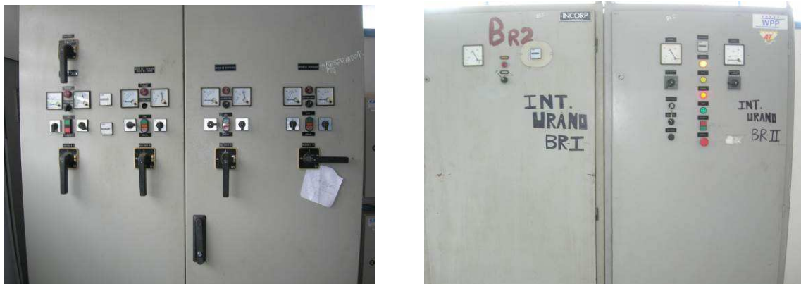
Figura 131 Acionamentos dos motores de 20CV e 125 CV – Destaque para a Identificação
