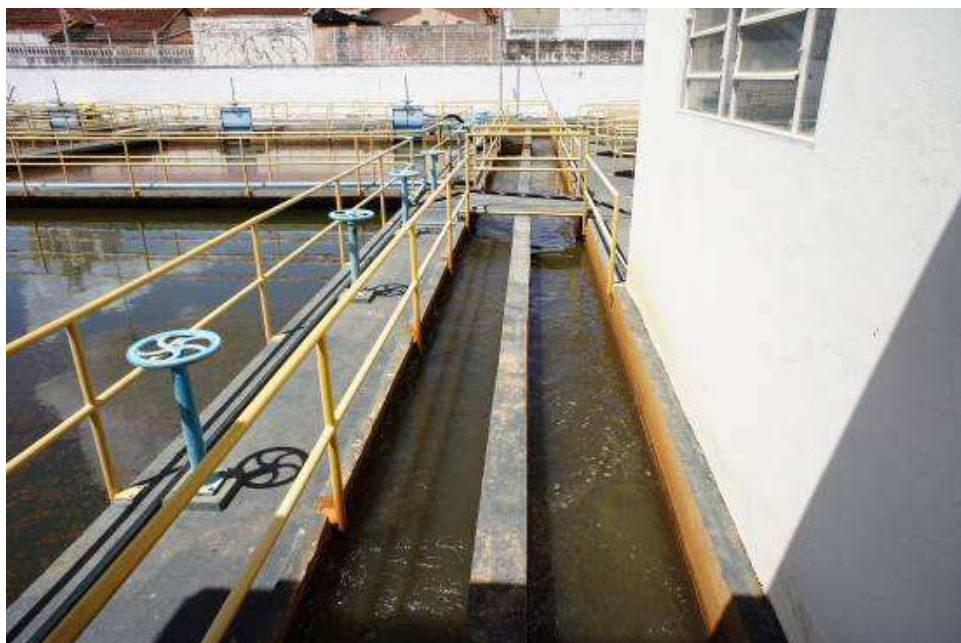
Figura 36 Vista geral do canal de água coagulada e alimentação ao sistema de floculação
