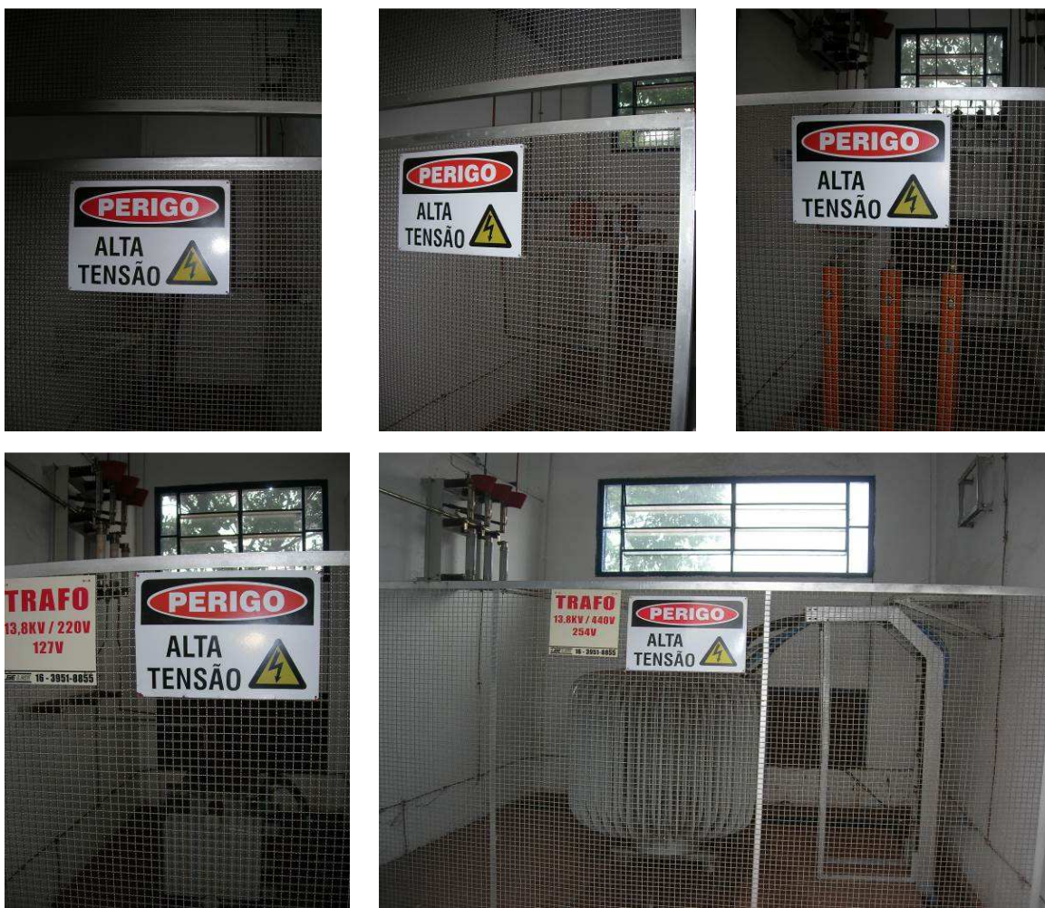
Figura 128 Sequência de Fotos da Subestação
