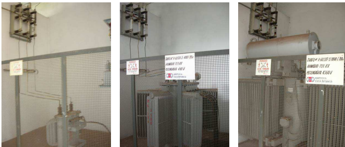
Figura 103 Sistema Solo Sagrado: unidades transformadoras 75kVA 220/127V, 500kVA-440 Vca e 2000kVA-4160V
