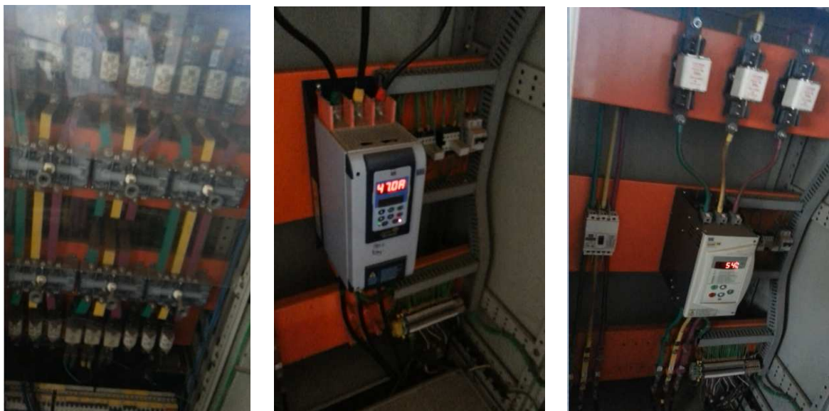
Figura 151 Fotos internas dos quadros, geral e de acionamentos
