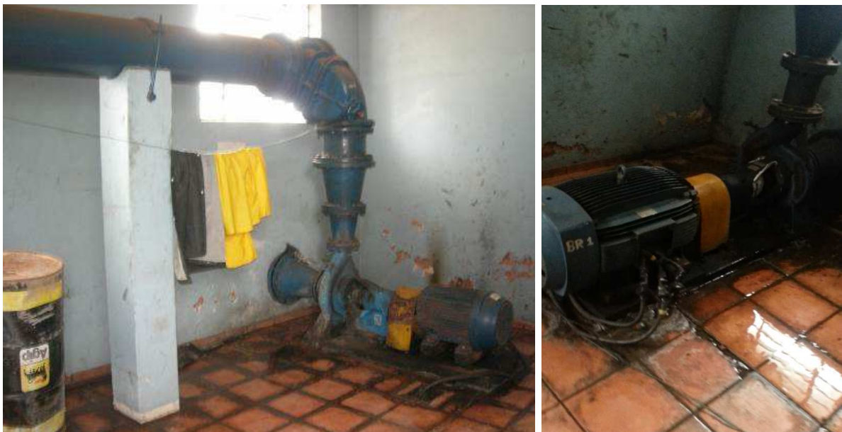
Figura 125 Casa de bombas – cjs de 100CV-220Vca
