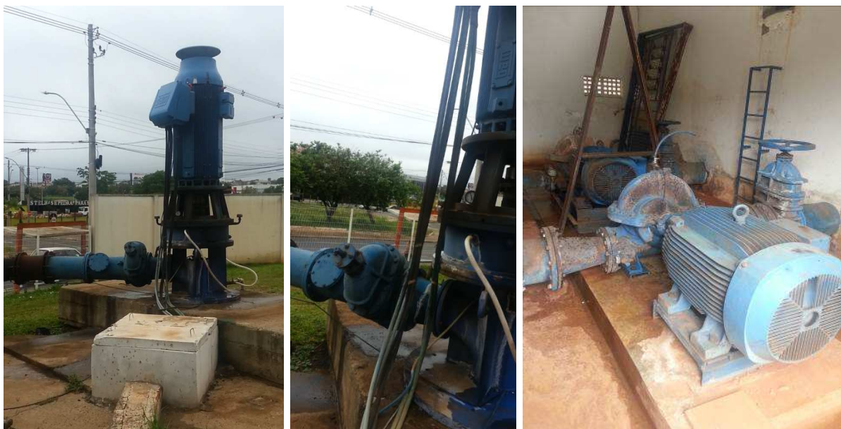
Figura 114 PTG de 600 CV, cabos mal acondicionados e conjuntos dos recalques com vazamento excessivo
