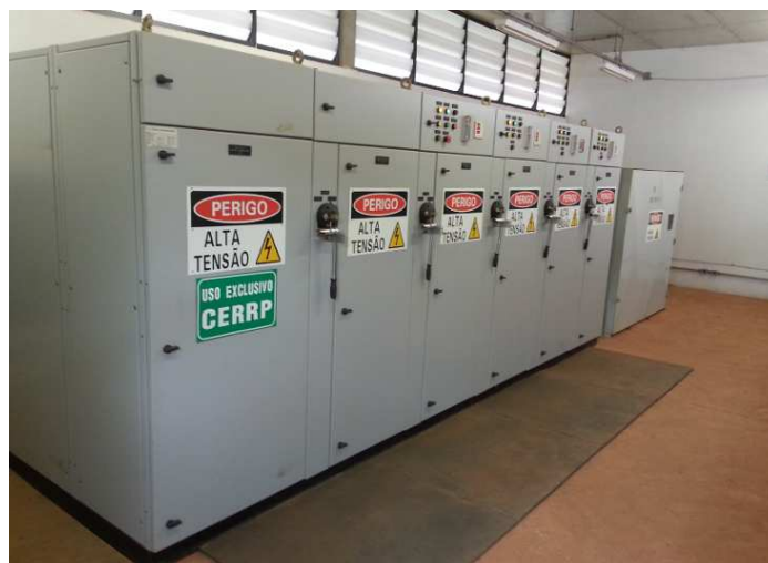
Figura 133 Cubículos da Subestação Principal e Trafo Auxiliar
