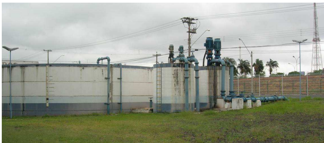
Figura 130 Recalques dos motores de 20 CV e de 125 CV
