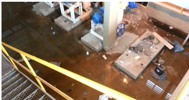
Figura 149 EEE Porto de Areia - conjuntos elevatórios
