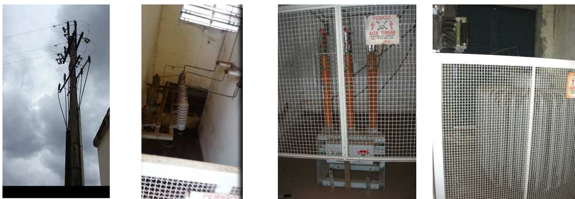
Figura 92 Entrada de energia e vista interna da cabine do PTG-001
