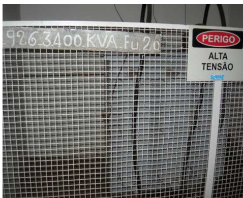
Figura 94 Identificação de transformador e alimentação de trafo na ETA
