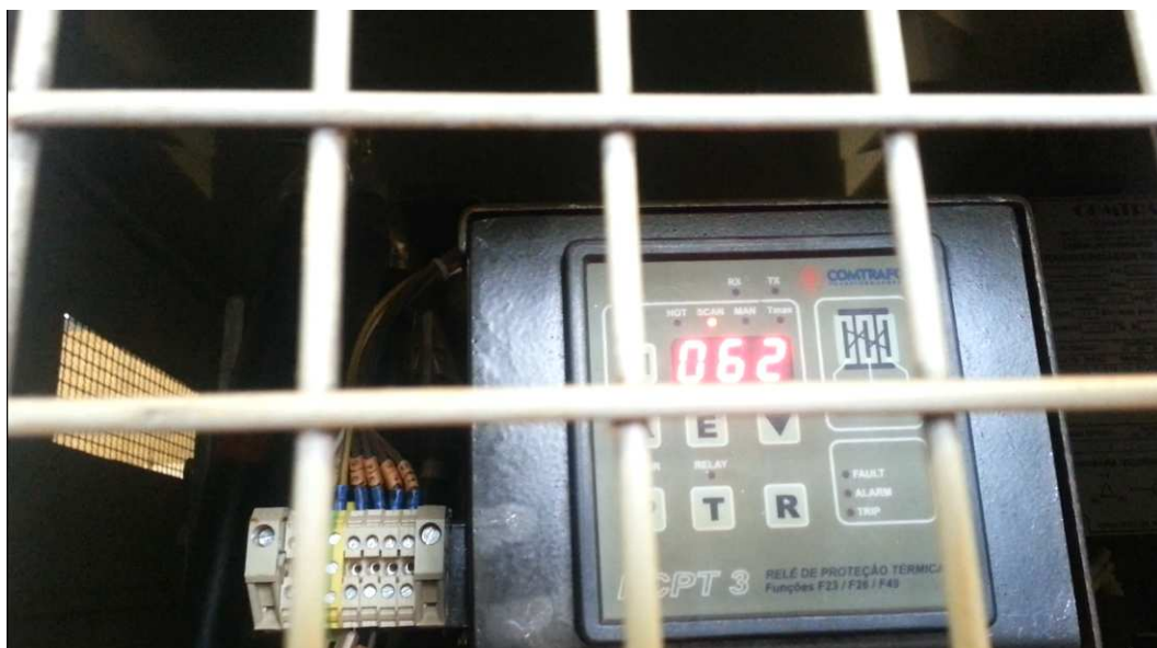
Figura 138 Proteção térmica do trafo seco da SE da EEEB
