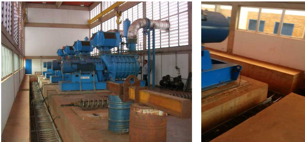
Figura 141 Vista dos sopradores e das canaletas de cabos sem tampa e proteção
