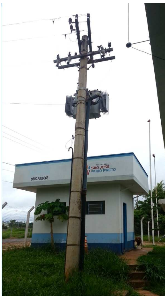
Figura 147 EEE Porto de Areia. Vista da entrada de energia – PPS
