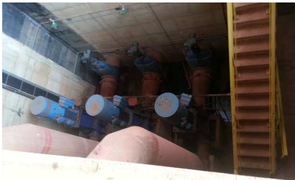
Figura 135 EEEB: conjuntos moto bomba
