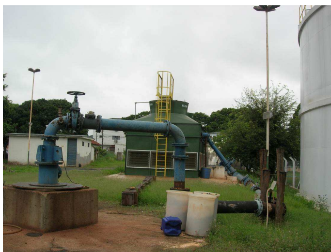
Figura 122 Vista do PTG, Torre de Resfriamento e novo Reservatório Apoiado metálico
