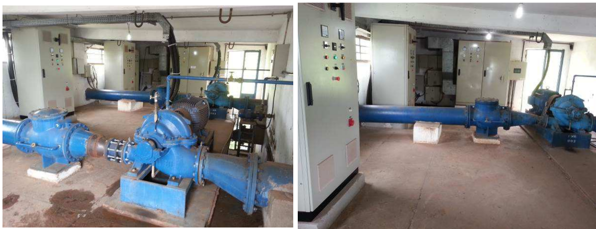
Figura 110 Casa de máquinas e painéis
