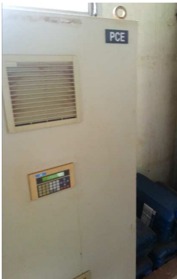
Figura 153 Vista do painel de controle da estação – PCE
