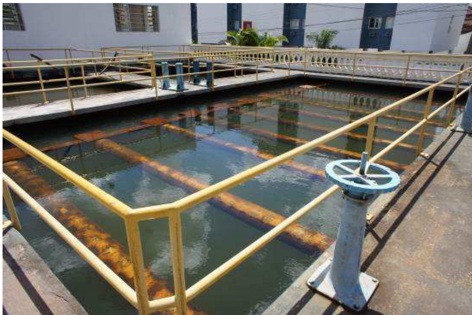
Figura 40 Vista geral de uma estrutura típica de coleta de água decantada de um dos decantadores
