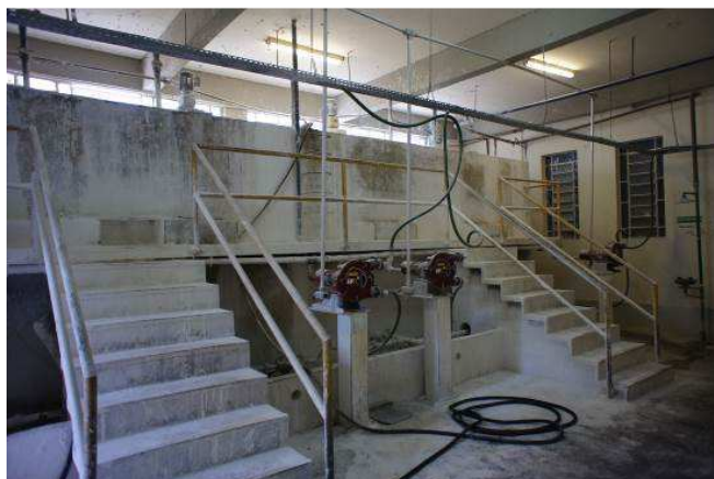
Figura 34 Vista geral dos sistemas de preparo e dosagem de cal hidratada
