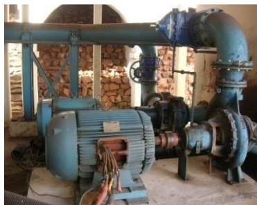
Alto Alegre - Motores de 250 CV- 440Vca e caixa de ligação/fiação
