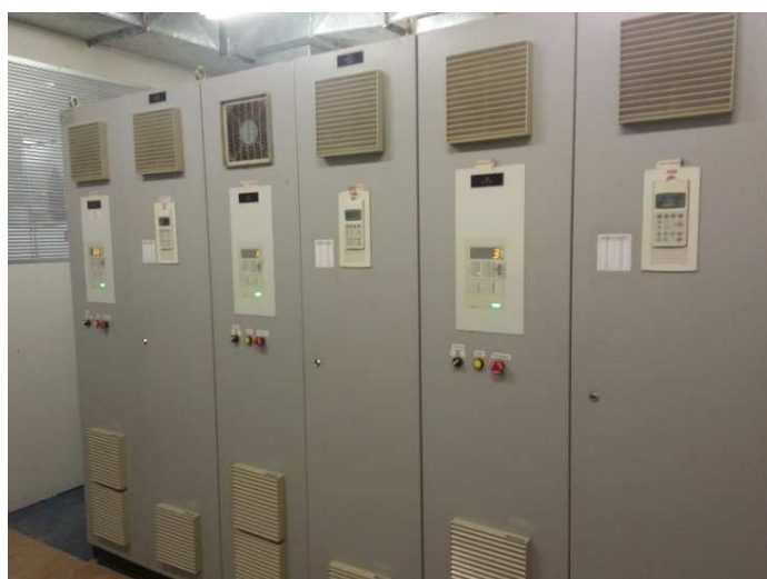
Figura 139 Inversores dos motores da EEEB
