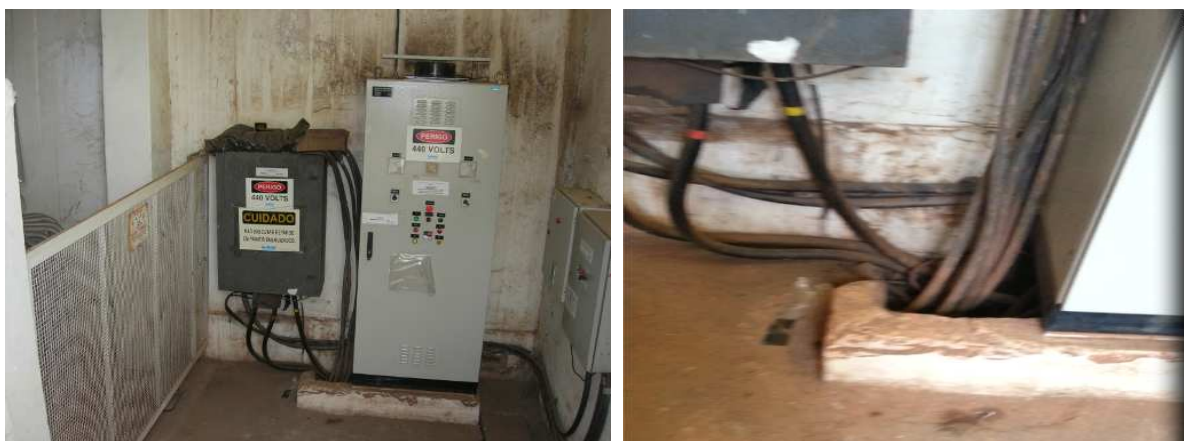
Figura 93 Vista dos painéis e detalhe da entrada e saída de cabos
