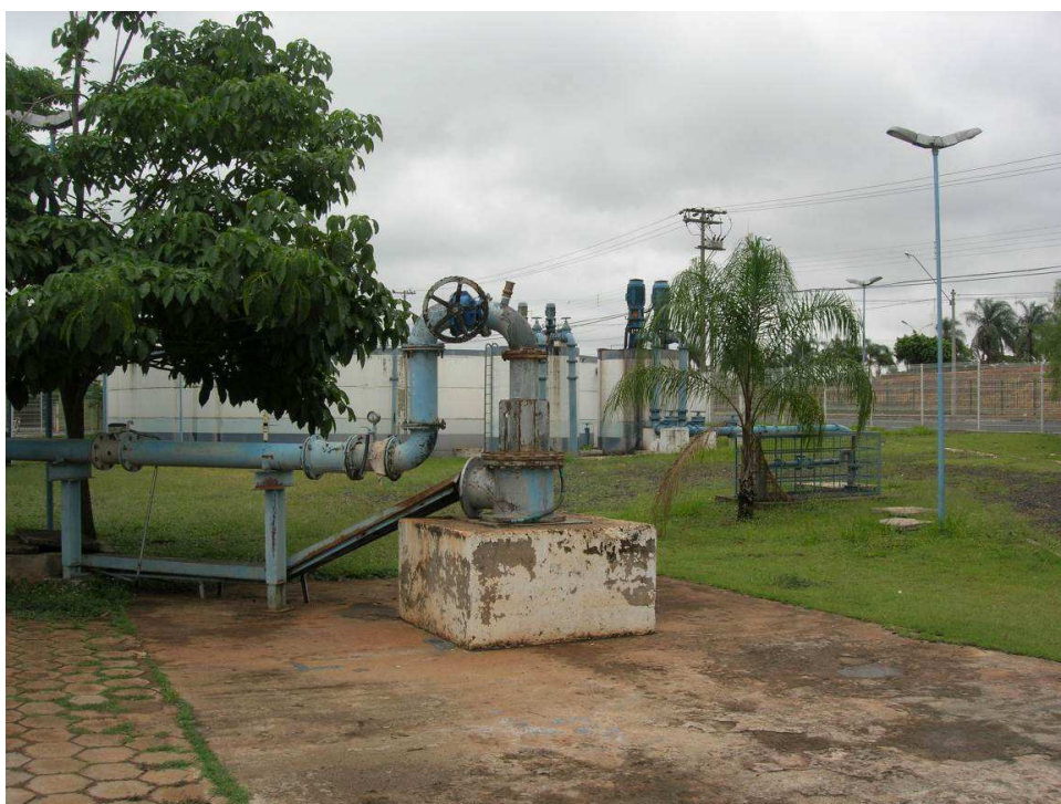
Figura 129 Vista do PTG submerso de 350 CV em primeiro e dos recalques de 125 CV e reservatório semienterrado
