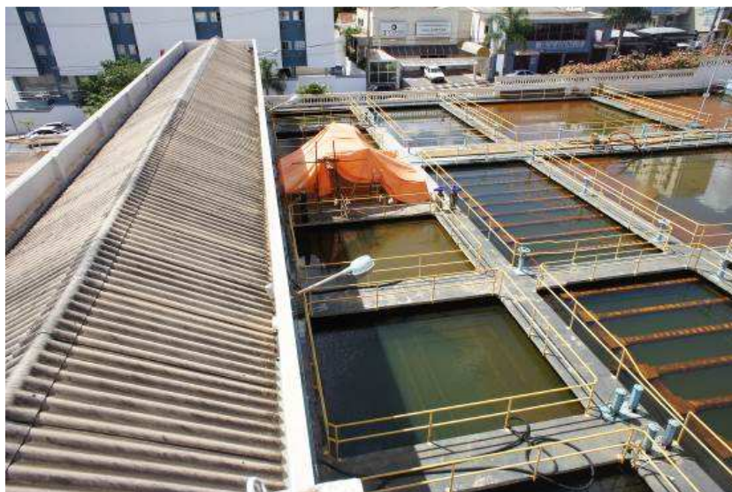
Figura 41 Vista geral dos filtros em operação
