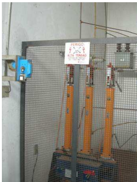
Figura 102 Disjuntor com relé primário e TP's ao fundo
