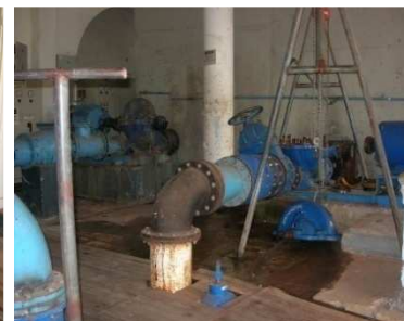
Reversível em manutenção, piso de madeira
