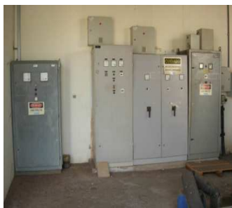
Alto Alegre - Painéis: quadro, acionamentos e capacitores
