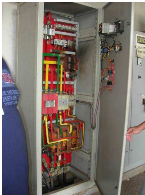
Figura 96 Vista interna de painel, necessidade de NR-10
